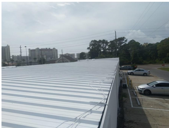
Duża powierzchnia dachu przemysłowego - przykład zastosowania powłoki.
