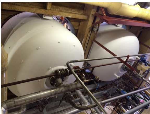
Zbiorniki i instalacje technologiczne - przykład zastosowania przemysłowego.
