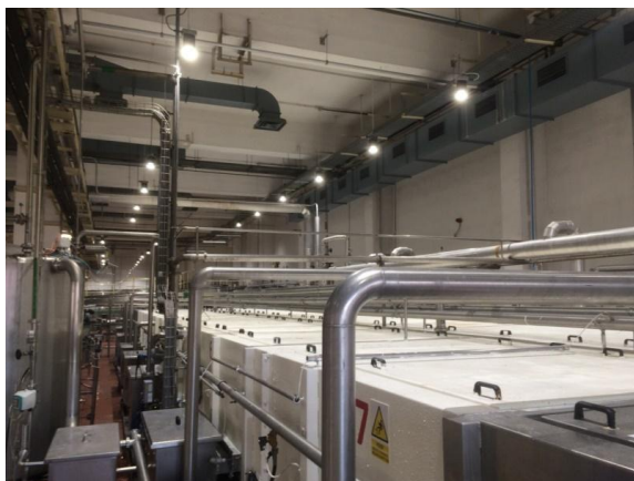
Instalacja technologiczna - zastosowanie na rurociągach i elementach urządzeń.
